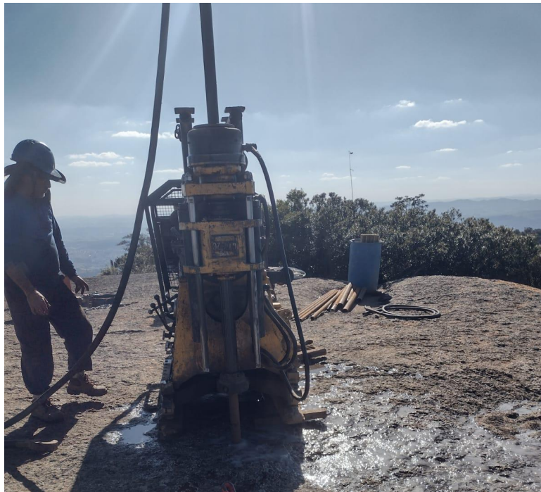
Figura 4 - Sondagem sendo realizada na laje da Pedra Grande na área inicialmente proposta pelo empreendedor (foto de 05/07/2023)
