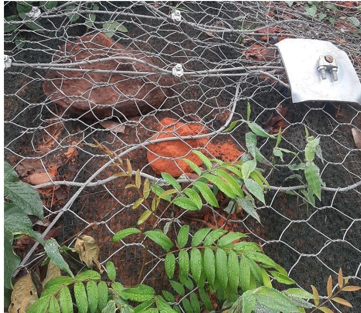
Figura 44: Blocos de rochas retidos pelas barreiras e redes de proteção contra quedas de blocos.
