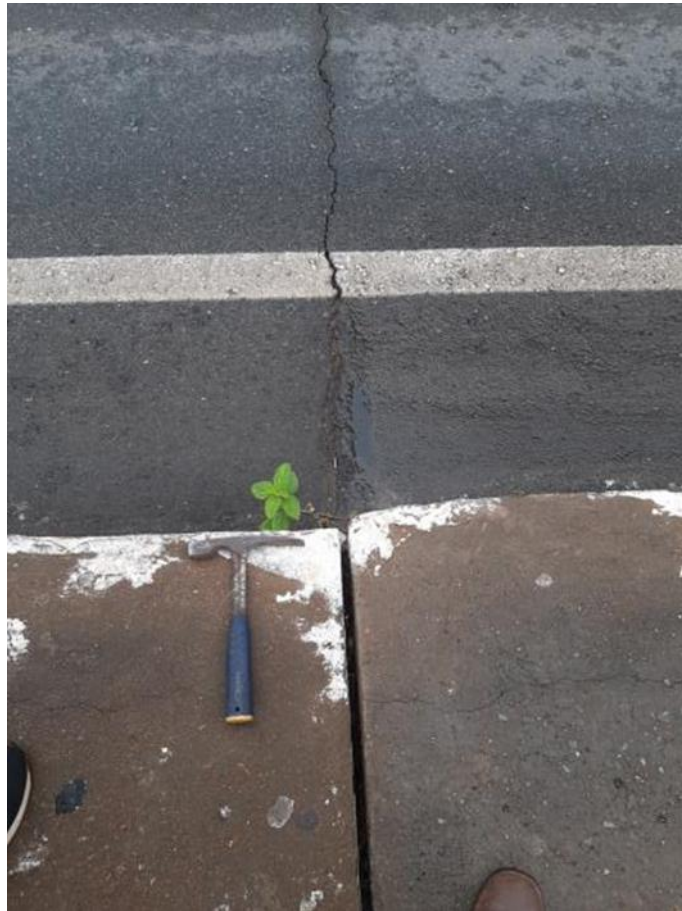
Figura 42: Diferença entre o nível da via fora da ponte e dentro da ponte
