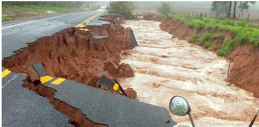
Figura 15: Erosão na MT 020
